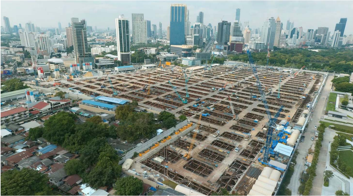
รูปที่ 10 งาน โครงสร้างภาพรวมทั้ง โครงการ
