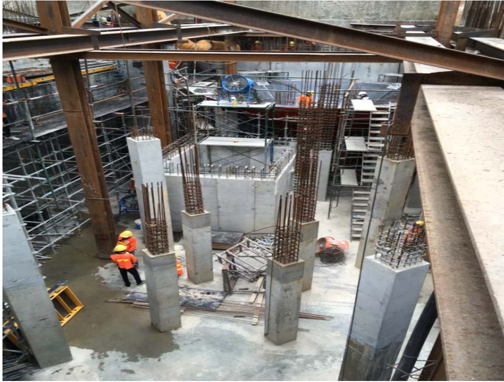
รูปที่ 12 งาน โครงสร้างหล่อเสาชั้น ใต้ดิน
