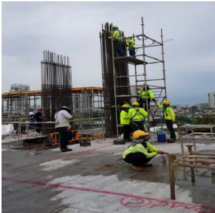
รูปที่ 2 งานหล่อไม้แบบของเสาและผนังลิฟต์
