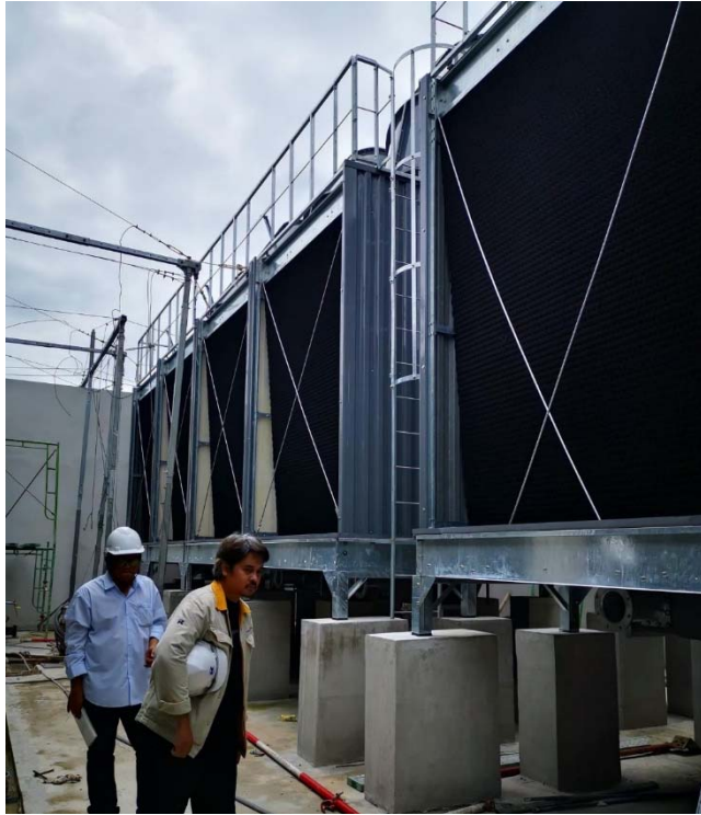
ภาพที่ 5 : พื้นที่ติดตั้ง Cooling Tower ชั้นหลังคา อาคาร B
