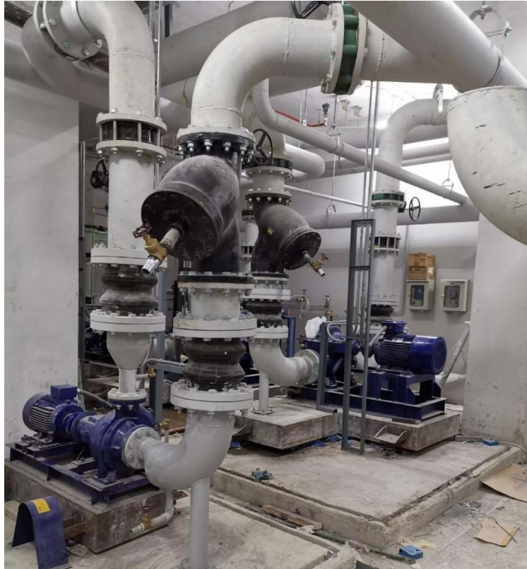
ภาพที่ 7 : ห้องเครื่องระบบปรับอากาศ
