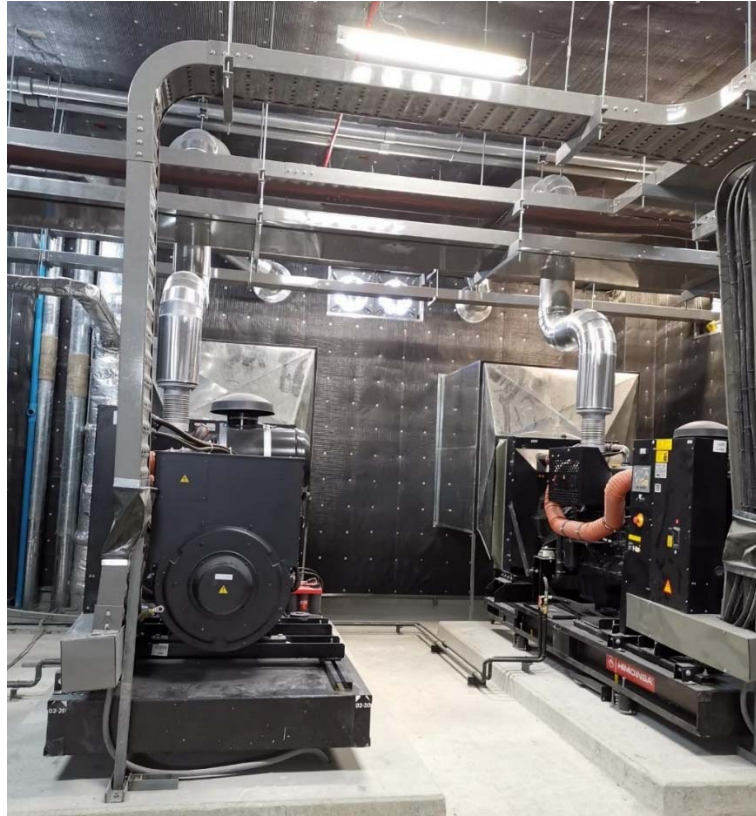
ภาพที่ 9 : ห้องเครื่องกำเนิดไฟฟ้าสำรอง Generator
