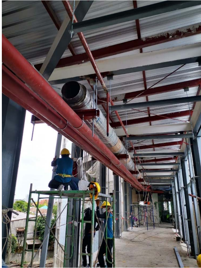
ภาพที่ 13 : การติดตั้งงานระบบระหว่างอาคาร A และ B บนทางเดินเชื่อมอาคาร
